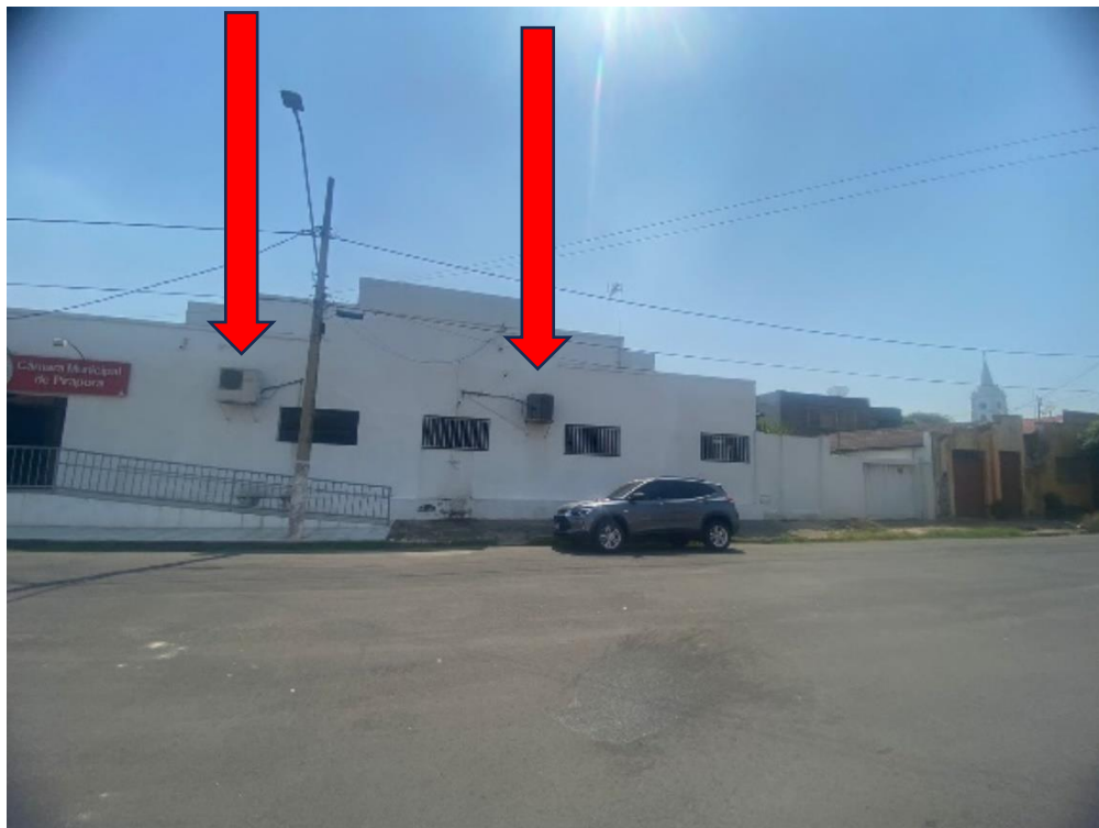
Imagem 12: Condensadoras de ar condicionados a serem removidas e instaladas nas paredes laterais.
